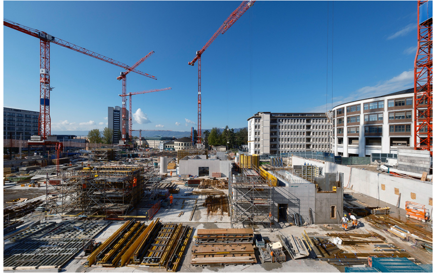
↑ Auf der Baustelle des Neubaus MITTE1|2 sind derzeit fünf Baukräne im Einsatz. Foto: ralpbensberg.ch
